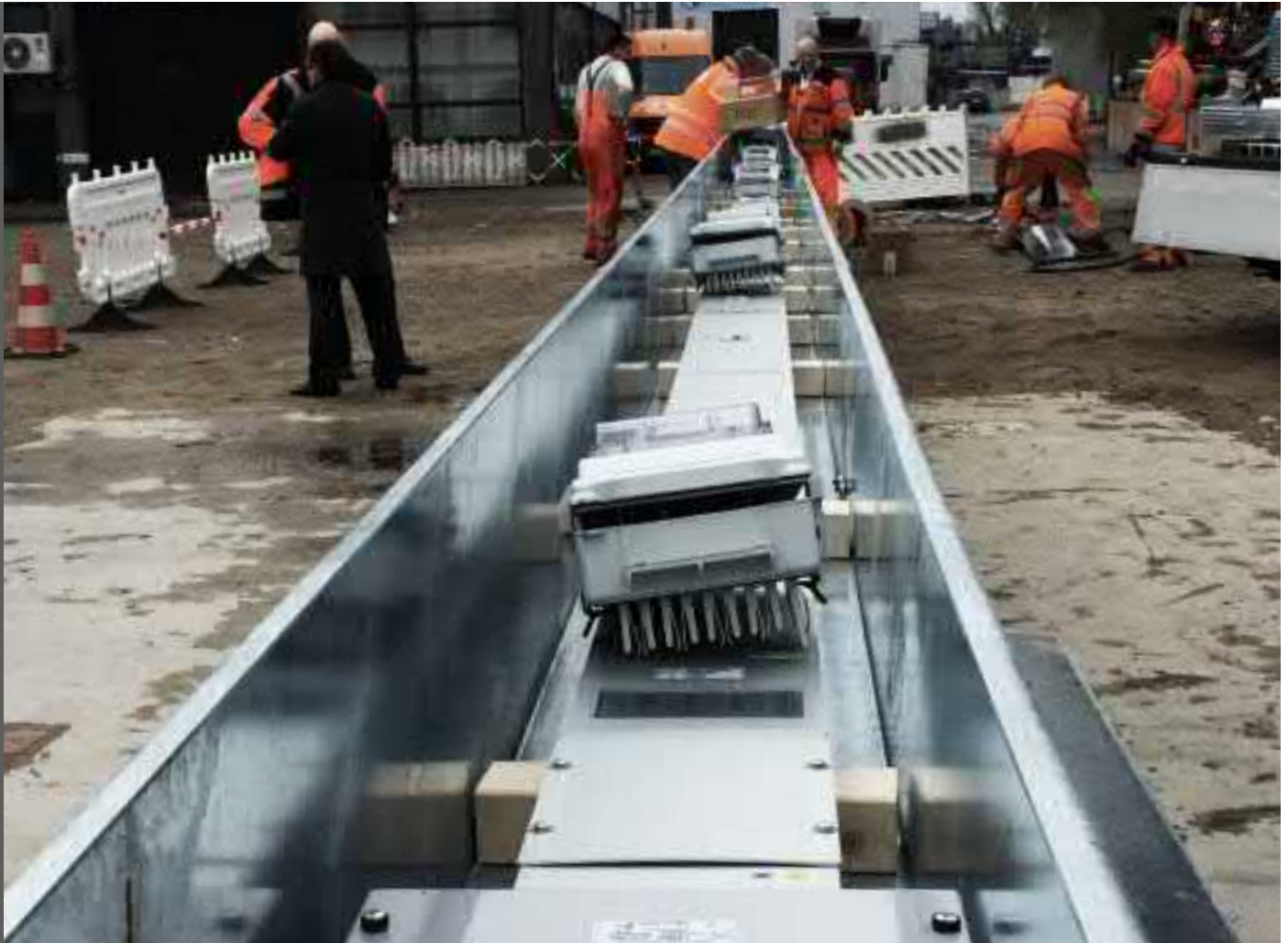
Blick in die Ladestruktur für 40 Fahrzeuge in Berlin 10553 Sickingenstraße 26-28
